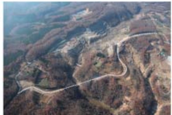
市道馬場駒の湯線道路災害復旧状況
