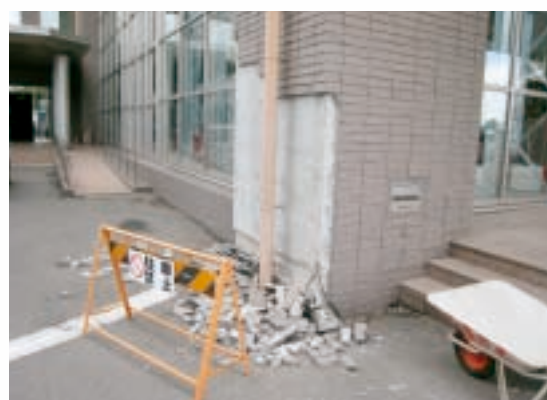
公共施設の被害状況 (市役所庁舎)
