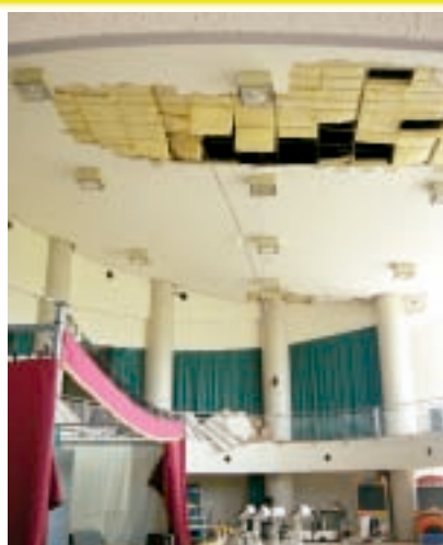
ハイルザーム栗駒アリーナ天井崩落の様子
