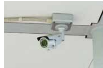
設置した防犯カメラ
