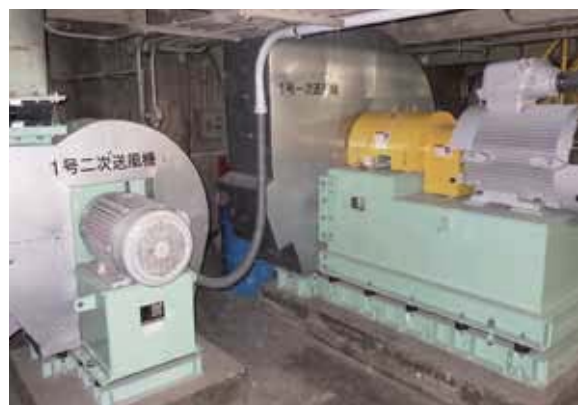
更新した一次送風機と二次送風機
