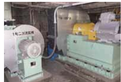
更新した一次送風機と二次送風機
