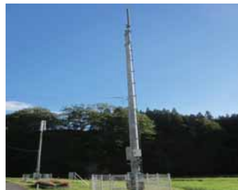
新たに設置した携帯電話基地局
