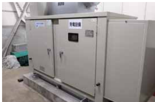
更新を行った非常用発電設備
