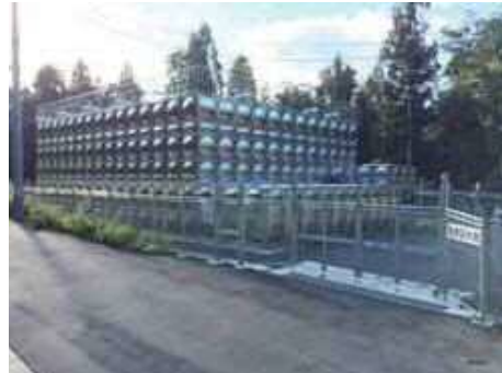
鶯沢南郷地区に設置した細倉配水池
