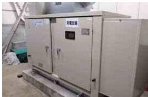
更新を行った非常用発電設備
