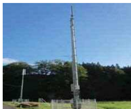
新たに設置した携帯電話基地局
