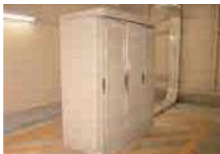
市役所本庁舎に設置した蓄電池設備
