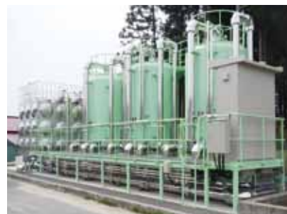
御駒堂浄水場に設置した高度浄水処理施設
