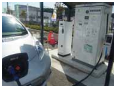
栗原市役所の 急速充電器設備
