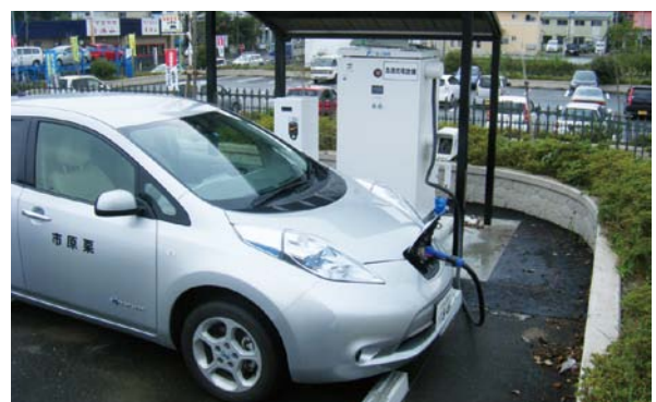
栗原市役所駐車場に設置した急速充電器(平成25年10月完成)
