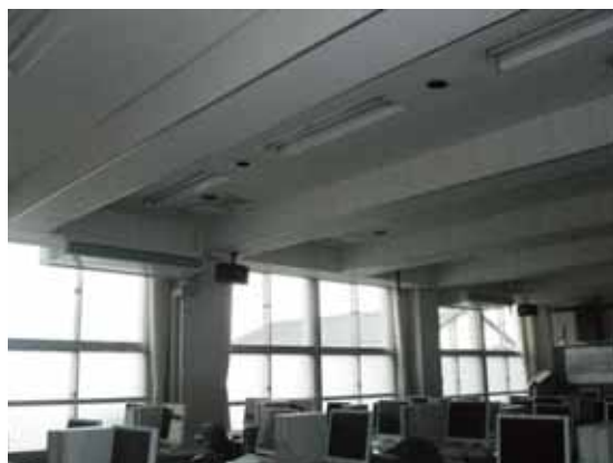
エアコンが設置された特別教室
