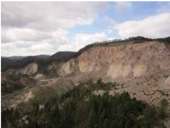
荒砥沢上流部の地すべり崩落現場
