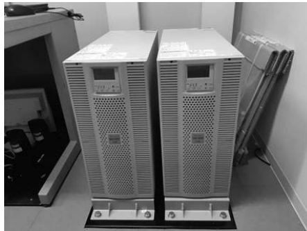
無停電電源バッテリー
