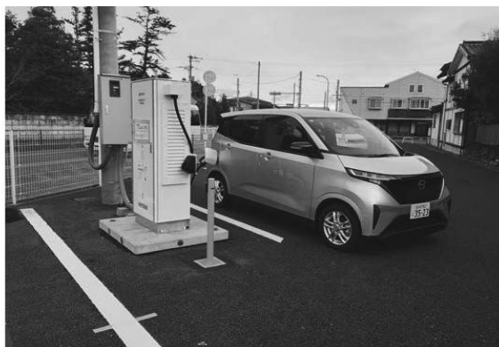
設置した電気自動車用急速充電器
