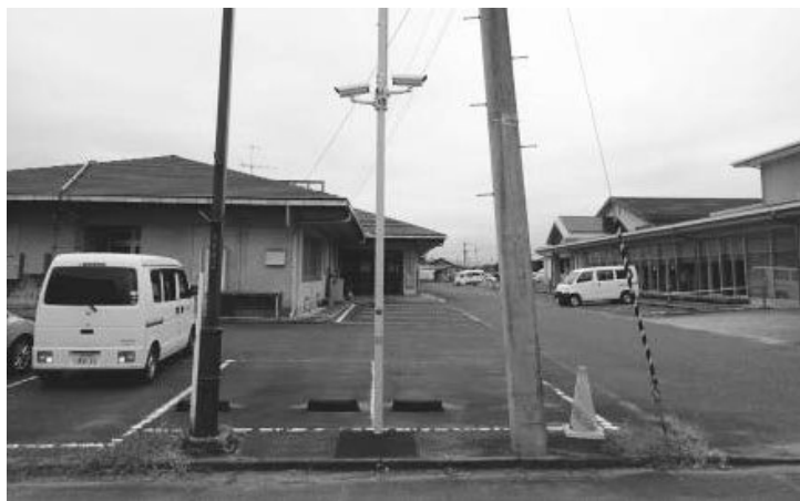
設置した防犯カメラ（一迫地区）
