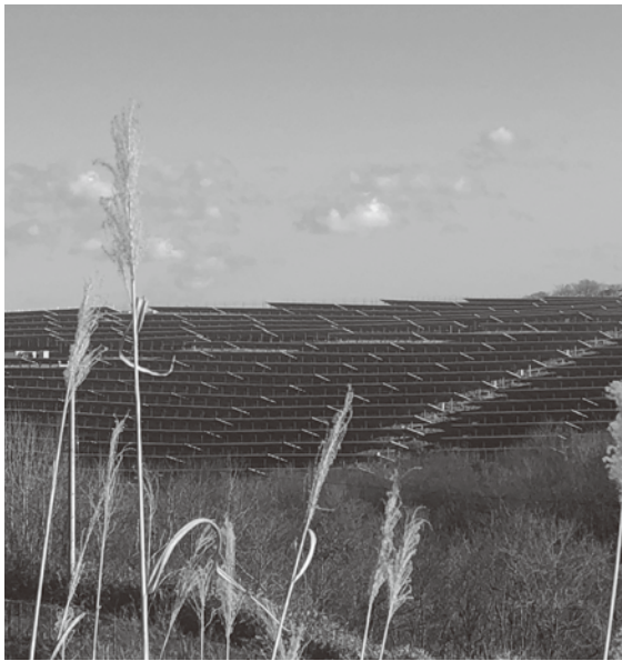
大規模太陽光発電のパネル(築館地区)
