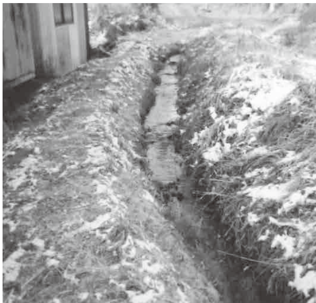
早期改修が望まれる水路
