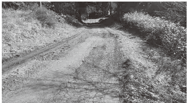
木材搬出などで傷んだ市道薬水線（栗駒）
