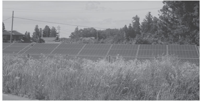
普及が進む野立て太陽光発電所
