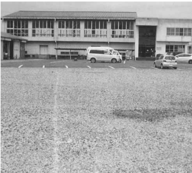
修繕が必要な志波姫体育センター
