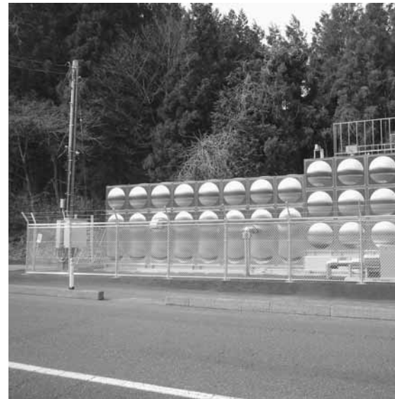
一迫地区堰場ポンプ場
