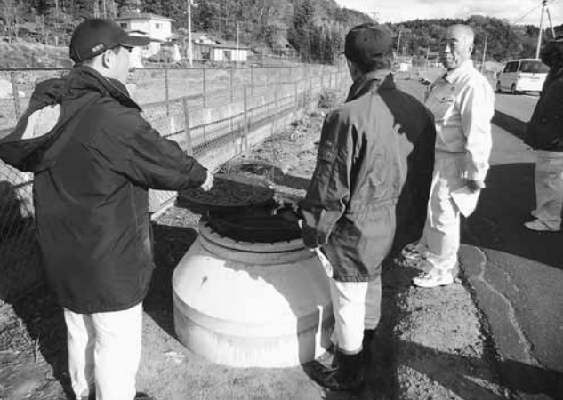
激震により隆起したマンホール
