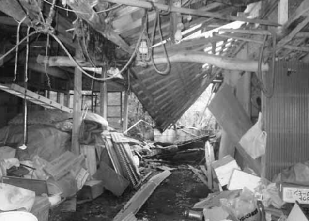
いまだ解体されない被災家屋
