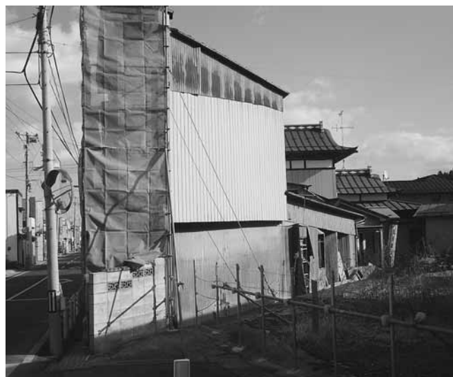
解体予定の被災家屋
