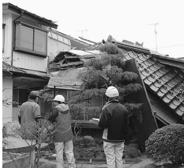
4月7日の余震で倒壊した民家
