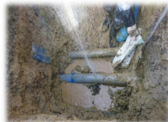
【破損により漏水した水道管】
