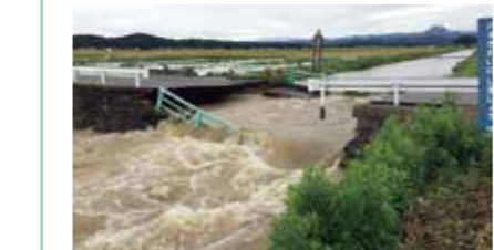
▲橋梁の流出(平成17年熊川橋[栗駒])
