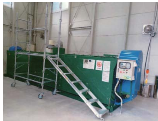
減容化処理装置
