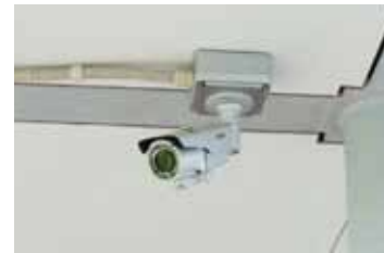
設置した防犯カメラ
