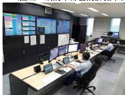
更新後の消防指令装置
