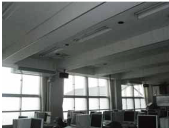
エアコンが設置された特別教室
